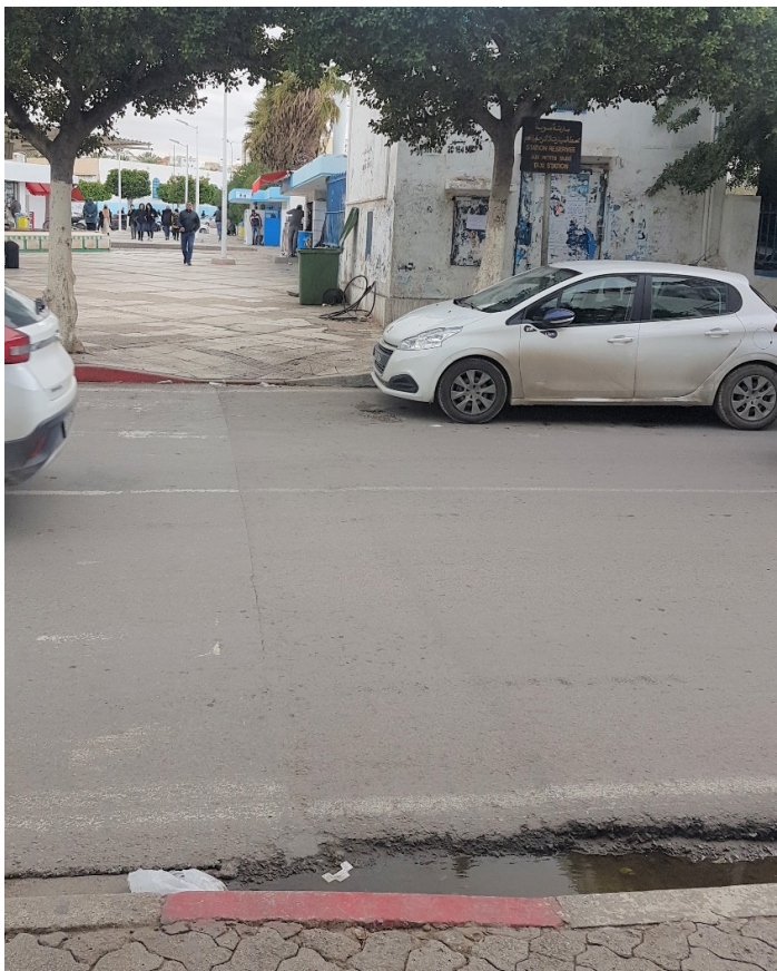
Figure 57 : Traversée au niveau du Bvd Ayachi : des abaissements de bordure ont été créés. Malheureusement, ces abaissements sont trop étroits pour permettre le passage de PMR. La jonction trottoir-chaussée n'a pas été faite à niveau : la différence de niveau provoque ici un espace en creux qui accumule les eaux de pluie et les déchets et dans lequel une roue (de fauteuil, poussette, bagages, etc.) peut se bloquer. La peinture horizontale s'est effacée et est désormais à peine visible. Photo : Kandeel, 2020
