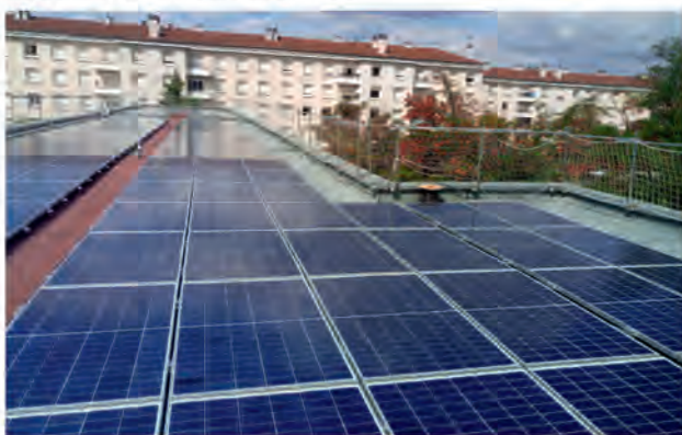
Installation photovoltaïque sur l'école maternelle des Gémeaux - 5ème arrondissement © Ville de Lyon
